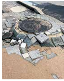
浮き上がるマンホール (石川県志賀町内)
